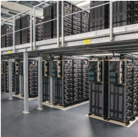
WEMAG-Batteriespeicher Foto: WEMAG, Stephan Rudolph-Kramer
