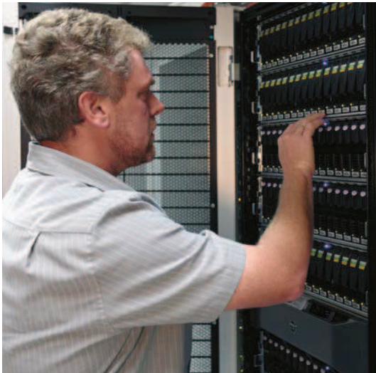
Mit dem Bauen Engel ausgezeichnetes Rechenzentrum in Oldenburg.
